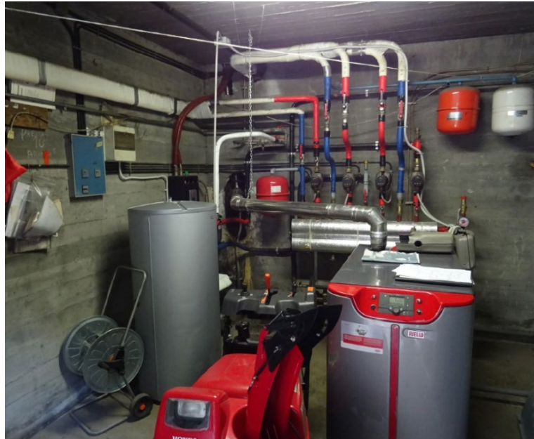
Figura 8 - Centrale termica con caldaia a gasolio a condensazione (C.I.T. 49455 Regione Piemonte)
